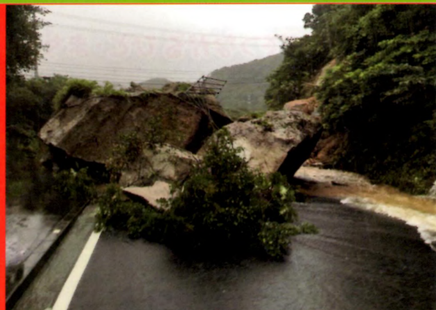
記録的な大雨による土砂くずれ
